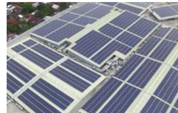
2018-2019: Solar Rooftop Portfolio
